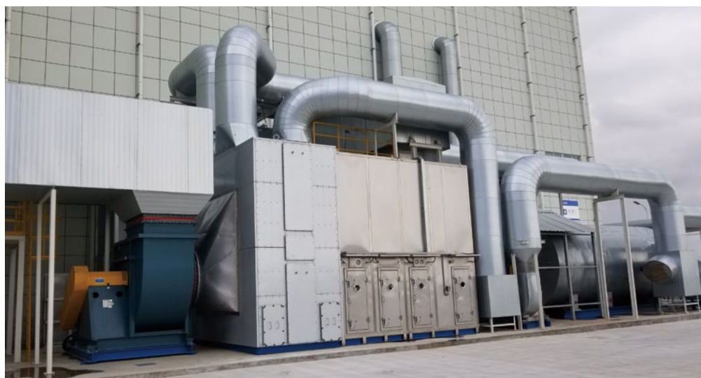
沸石转轮浓缩吸附 + TNV 焚烧系统
